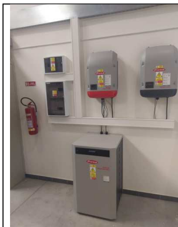
Střídače Fronius bateriovým úložištěm
